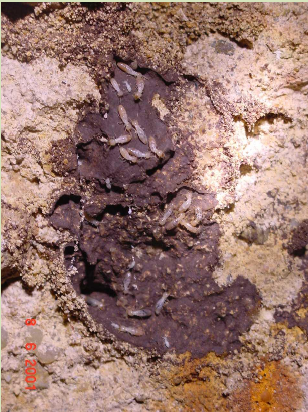
OUVRIERS DE RETICULITERMES DANS UN MUR EN MOELLONS
